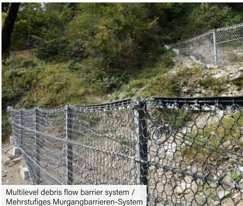
Geobrugg GUARD in operation / Geobrugg GUARD im Einsatz
